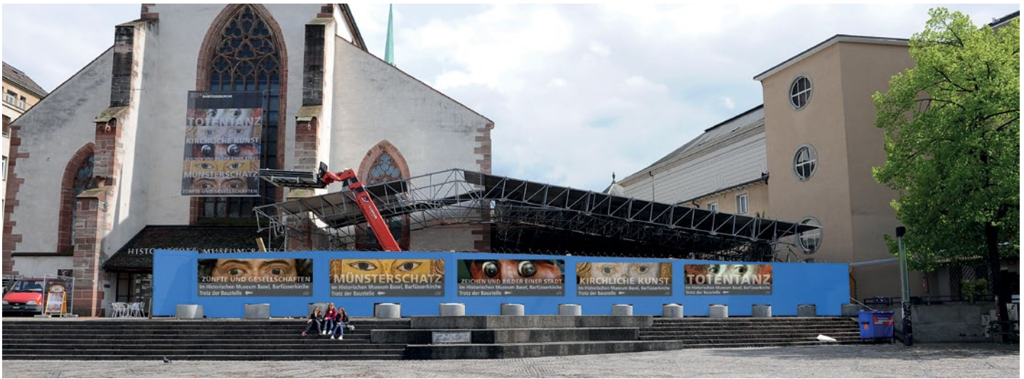
Mit einer aufwendigen Baumassnahme wurde von April bis Oktober 2009 das Flachdach über dem Sonderausstellungsraum des HMB saniert und die Pflasterung auf der Südseite des Museums erneuert. Damit ist die Gefahr von Wasserschäden in den Museumsräumen beseitigt.
